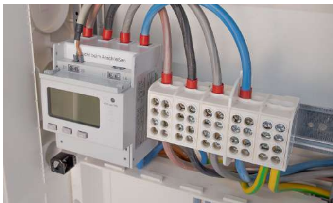
Abb. 36 ADL400 korrekt angeschlossen
